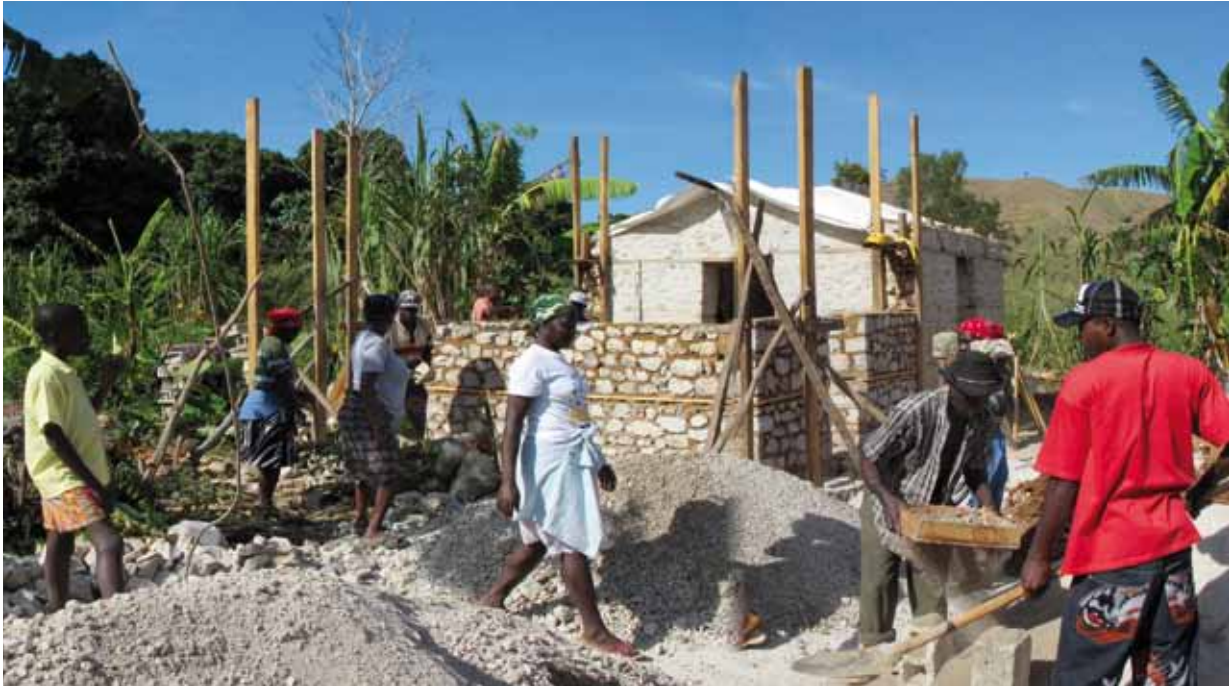
La communauté paysanne s'organise autour des chantiers : réunions, extraction des matériaux, transport, préparation des repas. Les familles organisées en kombits construisent ensemble leurs maisons à l'aide d'un ou deux boss.
