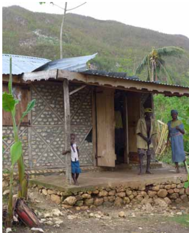
Maison auto-construite en 2013 selon les principes TCLA présentant seulement quelques dégâts mineurs après le passage de l'ouragan Matthew. Commune de Corail. © Croix Rouge Suisse
