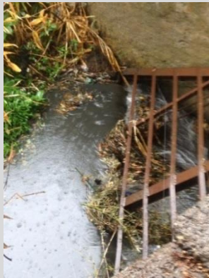
Foto 26. Acumulación de material en una rejilla. Chat Alerta temprana Ocloro , abril de 2017.
