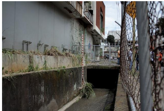
Foto 13. Punto 2 del Mapa 4. Canal colindante con la antigua Dos Pinos, dimensión de dos metros de alto por tres metros de ancho (Punto PT_17 del informe DEHC 2018 p. 83). Foto viendo hacia el norte: Guevara Viquez, agosto 2016.
