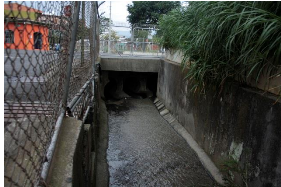
Foto 12. Punto 2 del Mapa 4. Canal colindante con la antigua Dos Pinos, dimensión de dos metros de alto por tres metros de ancho (Punto PT_17 del informe DEHC 2018 p. 83). Foto viendo hacia el sur: Guevara Viquez, agosto de 2016.
