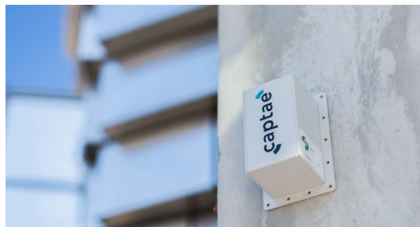
Figure 6. Solution captae ® du LERM setec pour le monitoring des structures [16]
