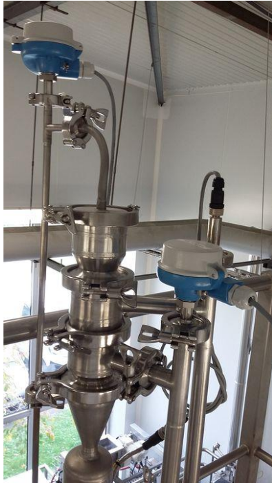
dispositif installé en tête du faisceau 3
