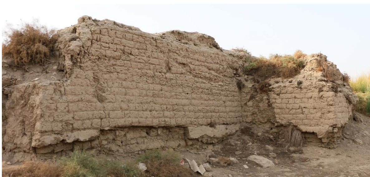
Fig. 27. Le cas ci-dessus illustre bien la combinaison de risques : érosion en haut des murs avec écoulements et éboulements, notamment dans l'angle, largement facilités par la végétation. À la base, l'accumulation de débris et la présence des plantes déterminent le développement d'un sillon destructeur évolutif car l'ensemble de ces éléments favorise la conservation de l'humidité ; Karnak, tronçon nord-sud du mur d'enceinte de la XXV e dynastie au nord des Catacombes osiriennes.
