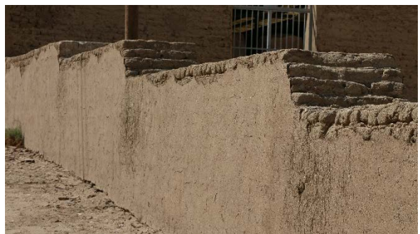
Fig. 51. Des érosions faibles au niveau des écoulements d'eau, mais à long terme ?
