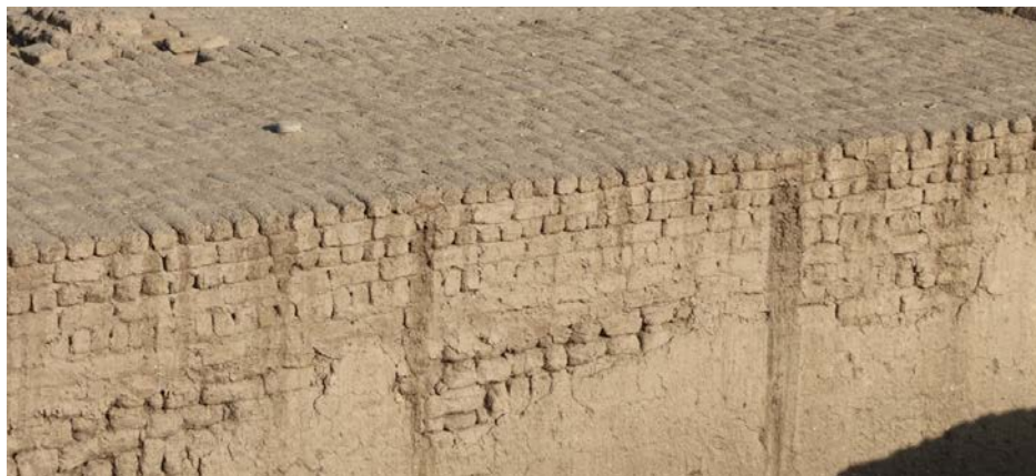
Fig. 18. Vue du mur d'enceinte ouest du Ramesseum, qui montre à la fois des concentrations d'écoulement d'eau – même sur une surface horizontale – et les effets de ré-déposition plus bas, en façade.
