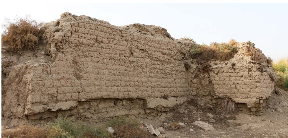
Fig. 27. Le cas ci-dessus illustre bien la combinaison de risques : érosion en haut des murs avec écoulements et éboulements, notamment dans l'angle, largement facilités par la végétation. À la base, l'accumulation de débris et la présence des plantes déterminent le développement d'un sillon destructeur évolutif car l'ensemble de ces éléments favorise la conservation de l'humidité ; Karnak, tronçon nord-sud du mur d'enceinte de la XXV e dynastie au nord des Catacombes osiriennes.
