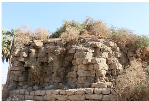
Fig. 38. La partie supérieure du bâtiment sur plate-forme est entièrement envahie par la végétation, surtout sur le côté nord.
