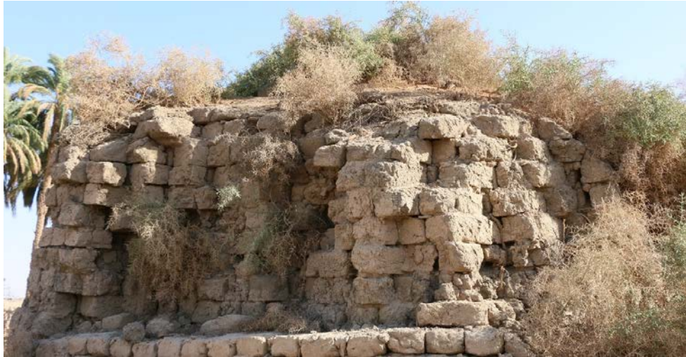
Fig. 7. Haut de construction en briques crues envahi par des plantes de aqul, sans dégradations importantes visibles. Il est néanmoins possible de prévoir une fragilisation à long terme de la maçonnerie (édifice sur plate-forme au nord de la première cour du temple d'Amon-Ré).
