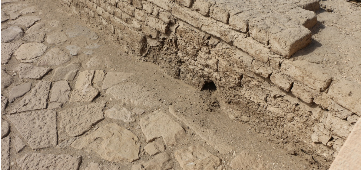
Fig. 43. Exemple d'effritement de la base d'un mur qui pourrait être dû à la présence du dallage en pierre (?).
