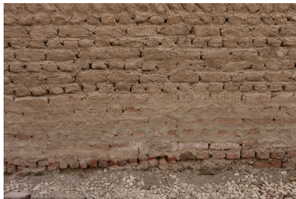
Fig. 22. Faible érosion à la base du mur qui laisse présager de la poursuite du phénomène
