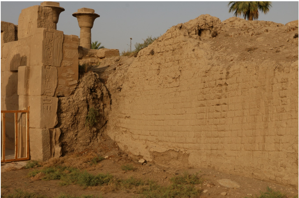
Fig. 29. Les effets combinés sont encore plus destructeurs dans le cas de constructions à angles rentrants ; Karnak, temple de l'Est.
