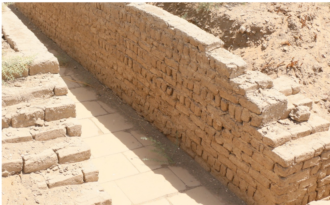
Fig. 23. Les dallages peuvent aussi être un risque si ceux-ci ne possèdent pas de pente naturelle amenant l'eau de pluie loin des murs (temple de Mout).
