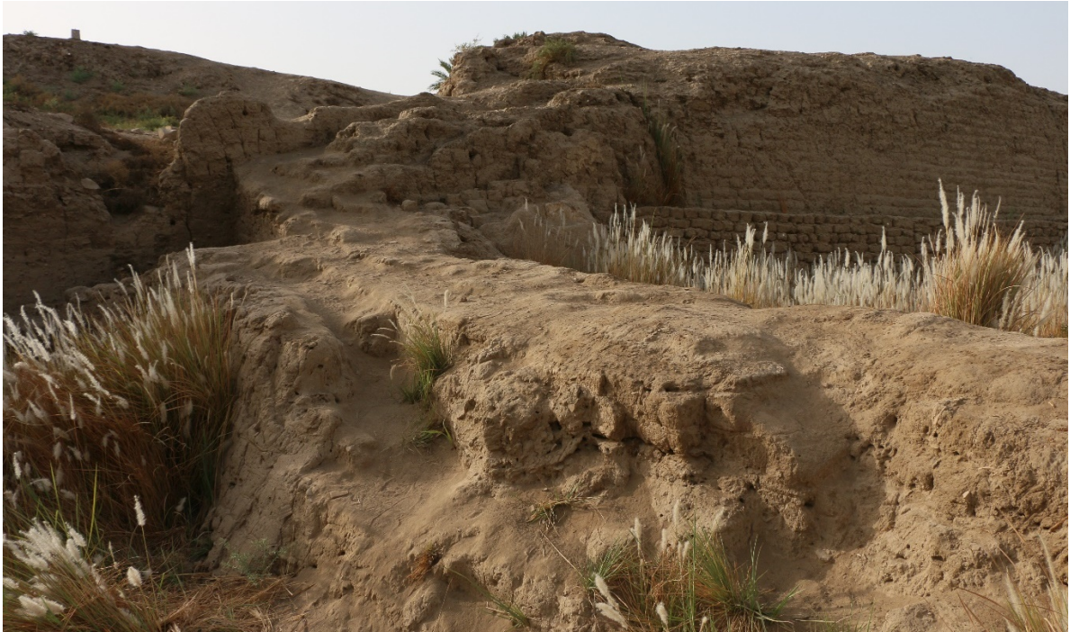
Fig. 28. Exemple de combinaison de l'action de l'homme et des écoulements d'eau de pluie avec, des deux côtés du mur, la menace représentée par les plantes (halfa).
