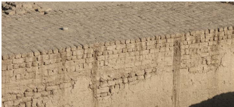
Fig. 18. Vue du mur d'enceinte ouest du Ramesseum, qui montre à la fois des concentrations d'écoulement d'eau – même sur une surface horizontale – et les effets de ré-déposition plus bas, en façade.
