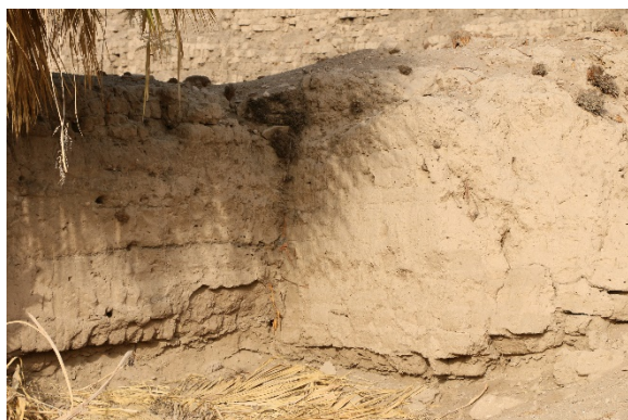
Fig. 21. Sillon destructeur à la base d'un mur.
