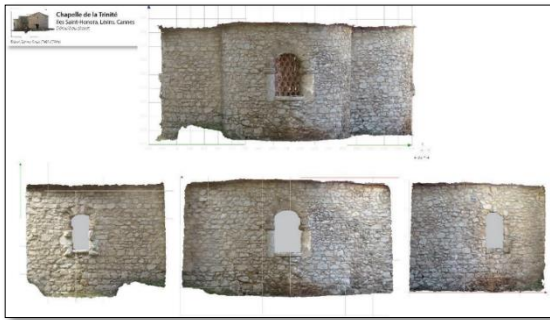
Figure 22 – Ortho-image développée, du chevet de la chapelle de la Trinité, Iles Saint-Honorat, Cannes (S.Sorin - CEPAM)
