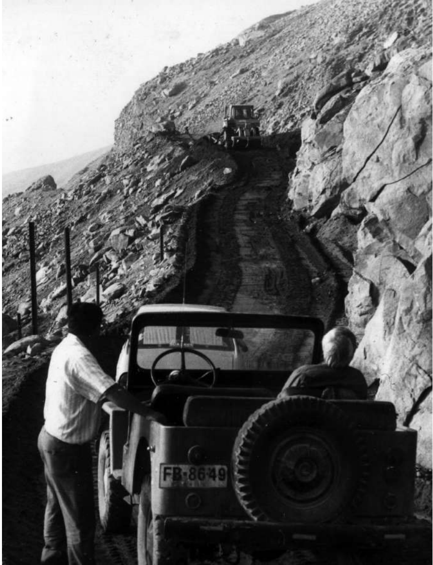
Trabajos de pavimentación del camino costero a cargo de la empresa Besalco. Enero 1994.
