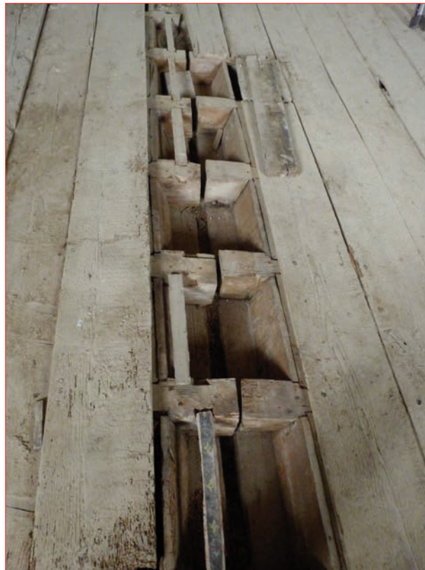
Photo 1 (en haut) : Plafond 1er étage, aile sud, vue vers l'est. Photo 2 (en bas) : Vue des abouts de solives avec les closoirs depuis le second étage, plafond du premier étage, aile sud.
