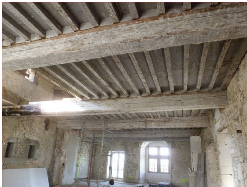
Photo 13 (en haut) : Solive moulurée du plafond du 1er étage de l'aile nord, avec 2 perforations obturées par des vestiges de cordage et de cale en bois.
