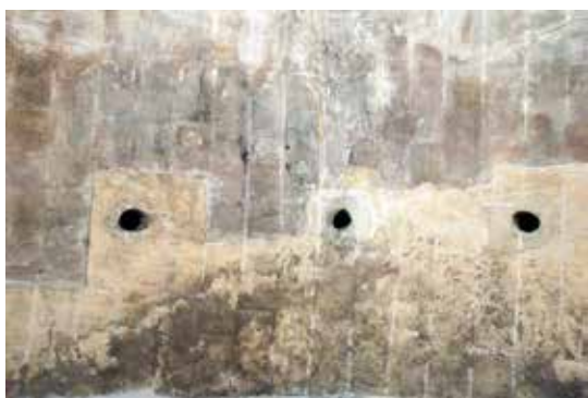
Fig. 1 : Chartres, Notre-Dame, voûte de la cathédrale. Trous circulaires vus depuis l'intrados avec un mortier blanc autour des orifices (témoins de restauration) et connexion avec l'enduit peint ancien.
