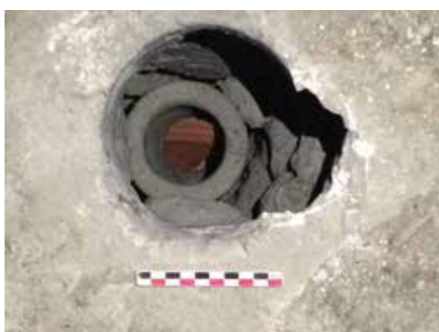
Fig. 6 : Chartres, Notre-Dame, combles d'une chapelle rayonnante. Agencement de la maçonnerie autour du conduit de bois aménagé dans le conduit traversant la voûte.
