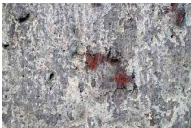
ill. 10 : Travée 4 nord, pilier est (P_3), colonne engagée sud : décor polychrome sur couche fibreuse.
