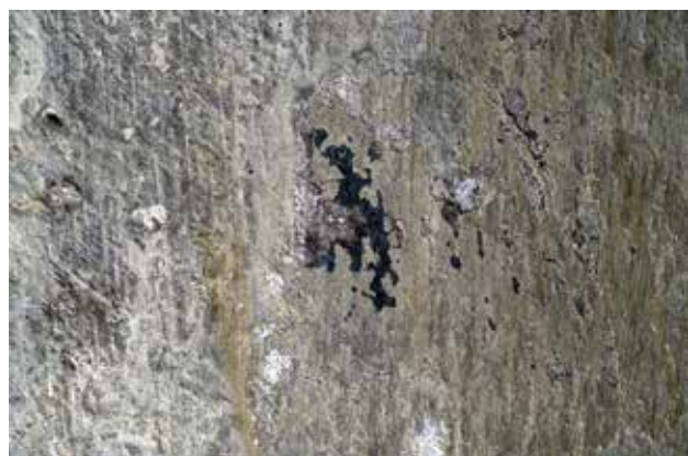
ill. 7 : Travée 3 nord, pilier ouest (P_1), détail du décor polychrome sur couche fibreuse au niveau de la colonne engagée sud.
