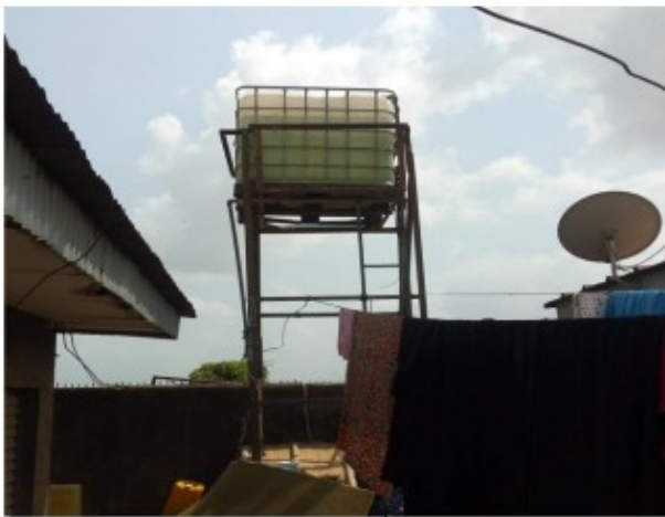
Réservoir alimenté par un forage à Dar Es Salam
