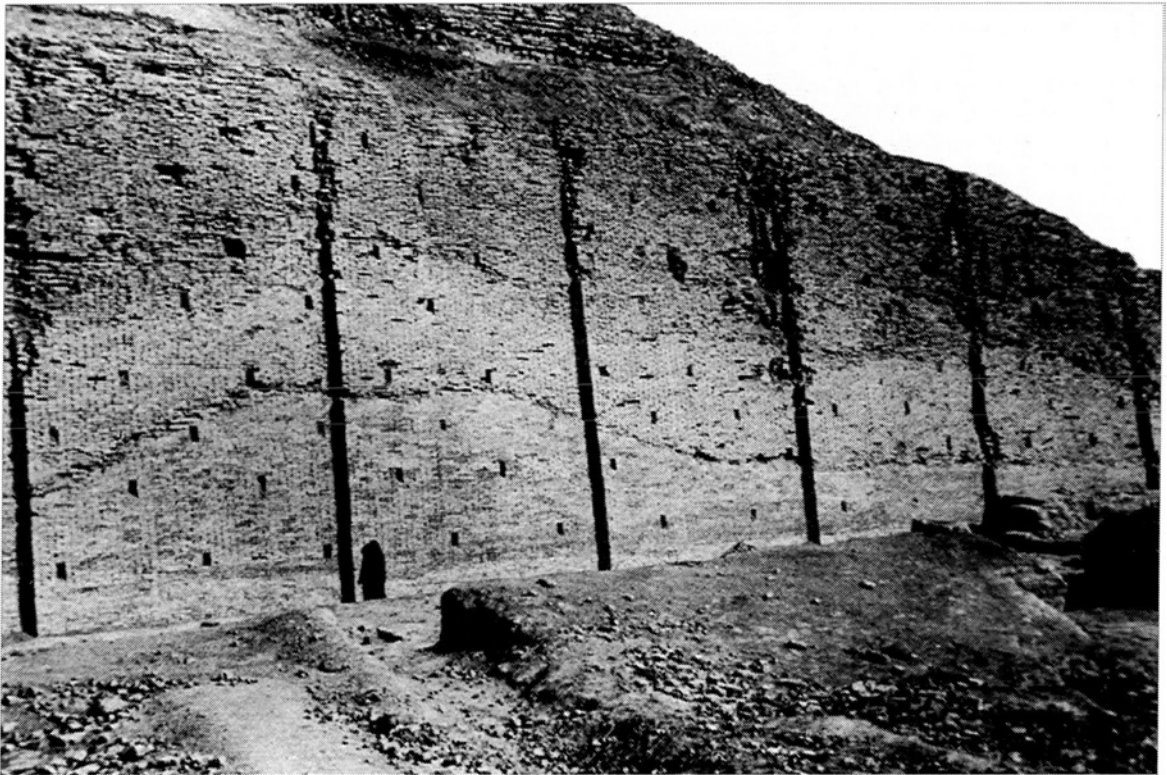
Fig. 6 : Ur : revêtement de briques cuites de la ziggurat avant restauration (d'après Woolley, 1939 : pl. 47).
