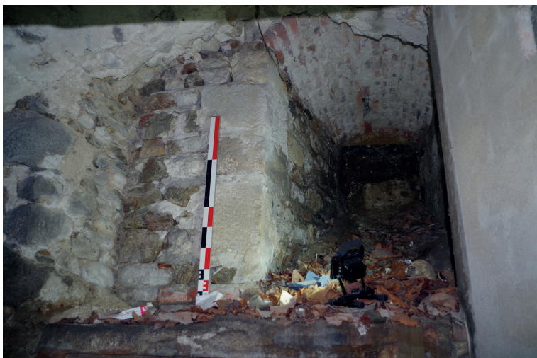
Figure 33 : Vestiges du piédroit est de la baie reprise par le soupirail nord des celliers ; cliché : D. Jouneau
