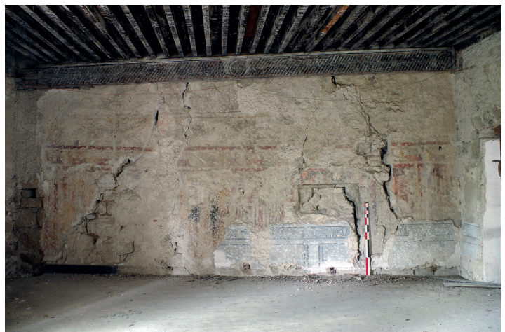
Figure 86 : Vue du mur ouest de la pièce 2.8, corps de bâtiment sud, deuxième étage ; cliché : C. Collomb
