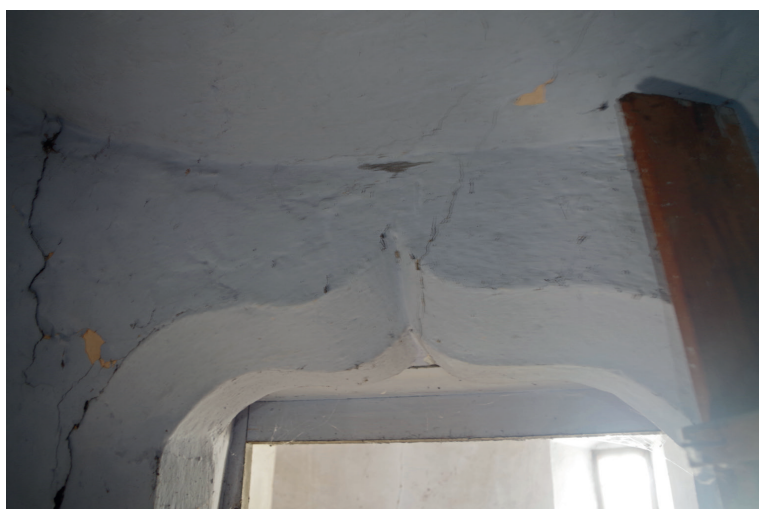
Figure 28 : Tour nord, deuxième étage, pièce 2.16 : arc en accolade de la porte ; cliché : D. Jouneau
