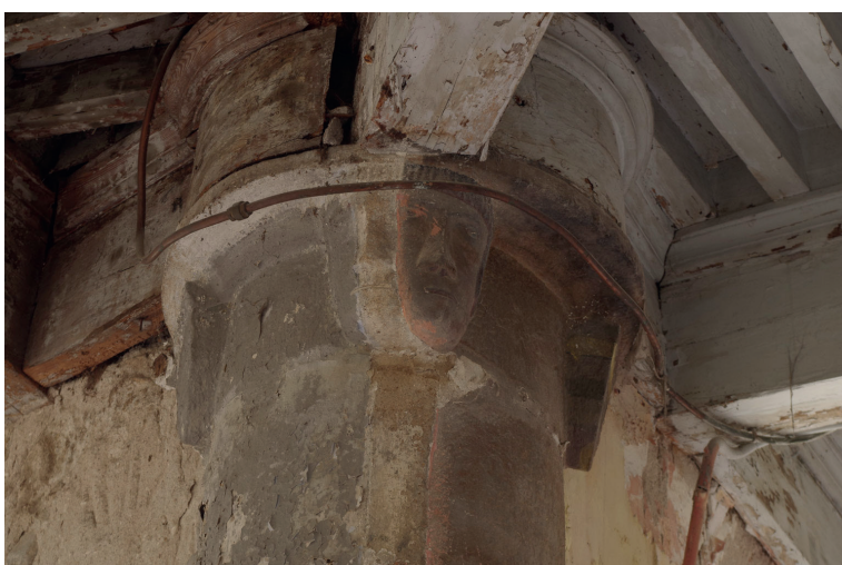
Figure 73 : Détail du chapiteau de la pile d'angle des galeries, au premier étage ; cliché : C. Collomb
