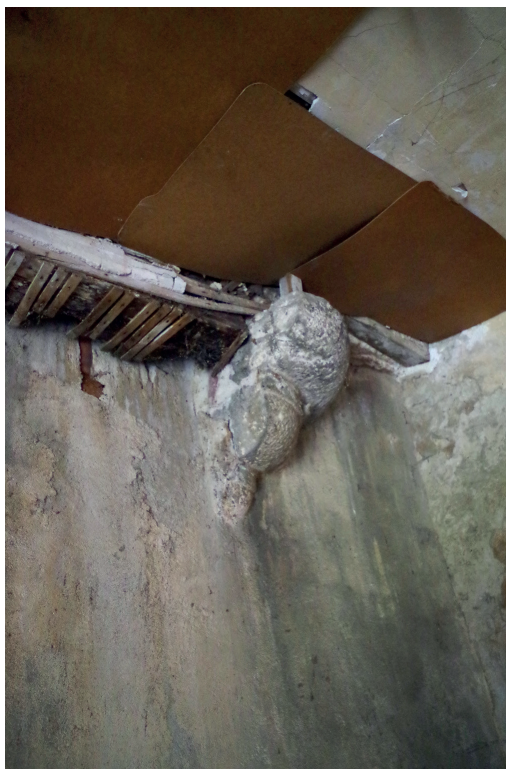
Figure 20 : Vue en contreplongée des latrines des premier et deuxième étages de la grosse tour ronde sud-est ; cliché : D. Jouneau
