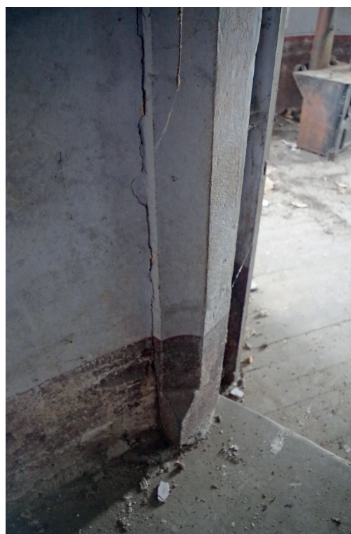
Figure 29 : Tour nord, deuxième étage, pièce 2.16 : congé du piédroit nord de la porte ; cliché : D. Jouneau
