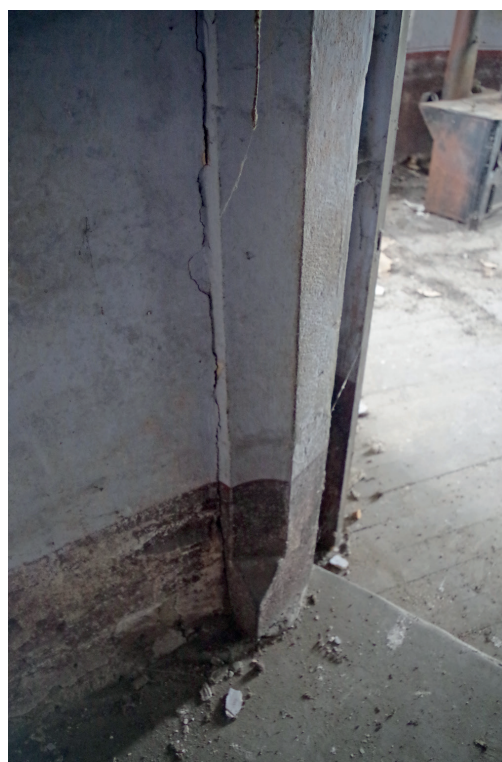
Figure 29 : Tour nord, deuxième étage, pièce 2.16 : congé du piédroit nord de la porte ; cliché : D. Jouneau
