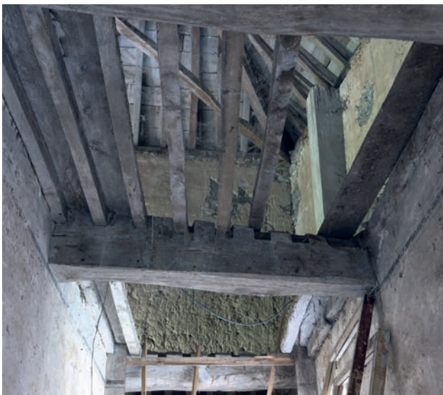
Fig. 3. Tour Dauphine, structure de plancher partiellement détruite, vue de l'est.
