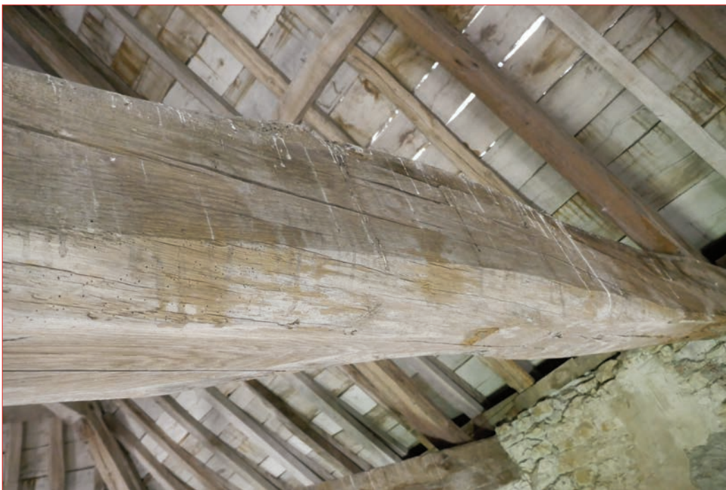
Photo 3 (en haut) : Mortaine rebouchée au centre de la face est (pour un coyer) de l'entrait de la ferme centrale. Photo 4 (en bas) : Mortaise rebouchée côté nord de la face est (pour un gousset) de l'entrait de la ferme centrale.
