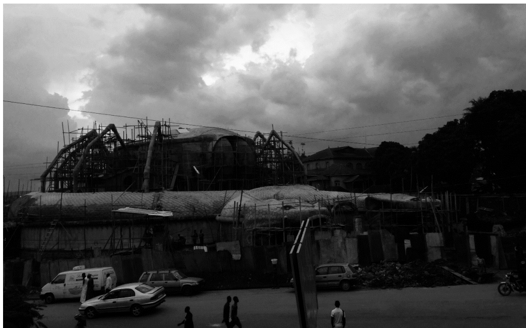
FIG. 66 MUSEE DES ROIS BAMOUN, ETAT AOUT 2016. L'ENTREE SE FAIT PAR LES GUEULES DES SERPENTS, LES SALLES CONSACREES AUX EXPOSITIONS SE TROUVENT DANS L'ARAIGNEE. NOTER LA SUPERPOSITION, DU PALAIS DU ROI NJOYA (EN ARRIERE-PLAN) ET DU NOUVEL EDIFICE (CL. A GALITZINE-LOUMPET)
