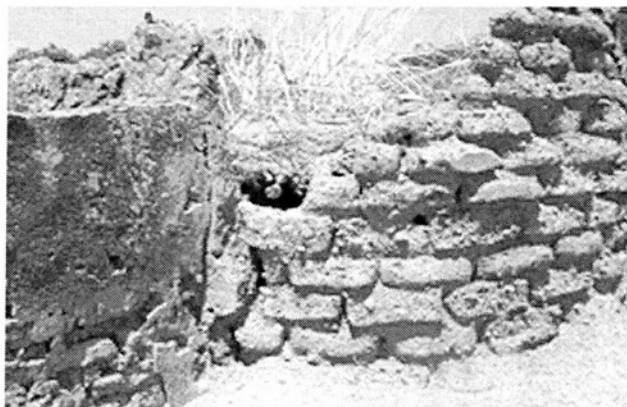
Fig. 2. Photo d'un mur de briques de terre crues érodé en « hérissron », Tiakané 2001 (Burkina Faso)
