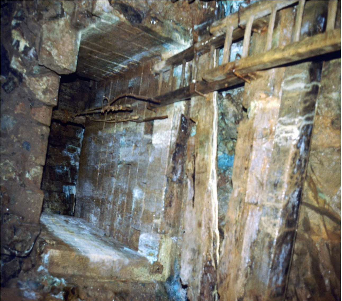
Illust 4 – concrétionnement contenant du sulfate de fer dans le puits de l'Engin, à Grandfontaine (Alsace). Photo H. Bari
