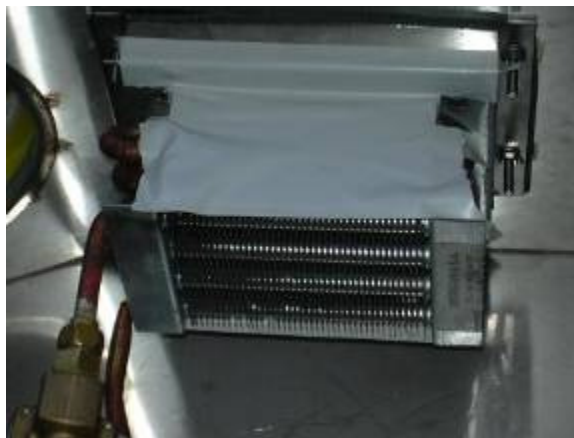
Figure 6.11 Batterie après bouchage de sa face supérieure
