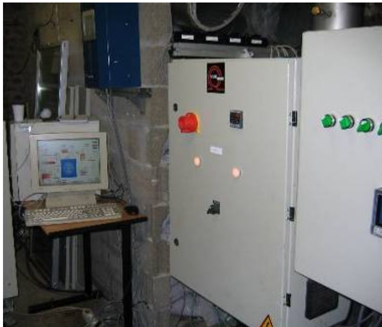
Console d'acquisition, boîtier du réchauffeur et boîtier électrique
