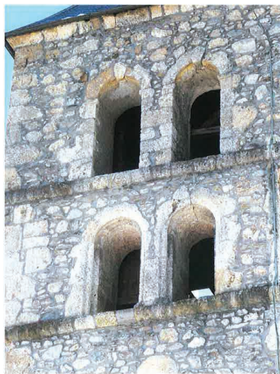
N°4 Baies Elévation Nord Ouest absence d'abat-sons
