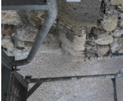
▲ Rupture de l'appareil du ressaut dans le parement de l'UM 3
