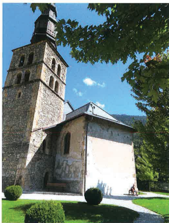
N°3 Angle Nord Ouest/Sud Ouest Clocher en maçonnerie apparente, les joints ont été repris au ciment
