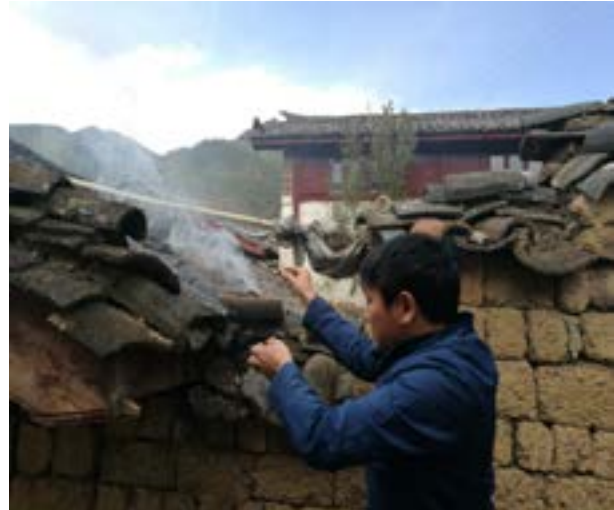
Illustration 15 : Dépôt de la tuile de cendres et d'offrandes sur un mur extérieur de la maison de He Y.
