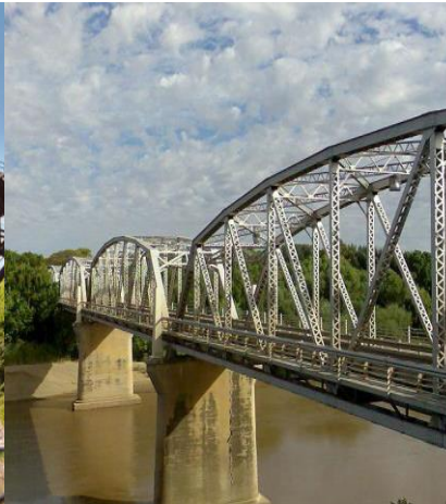
Figure 2. : Pont à quatre travées à treillis sur le fleuve Orange à Aliwal North [1].
