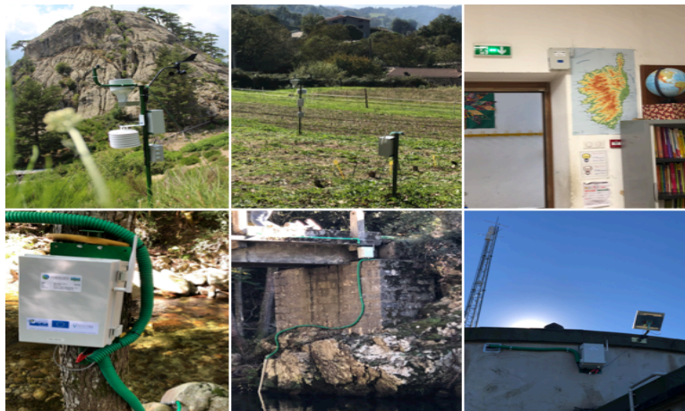
Figure 2 : Exemples de dispositifs déployés pour la surveillance environnementale
