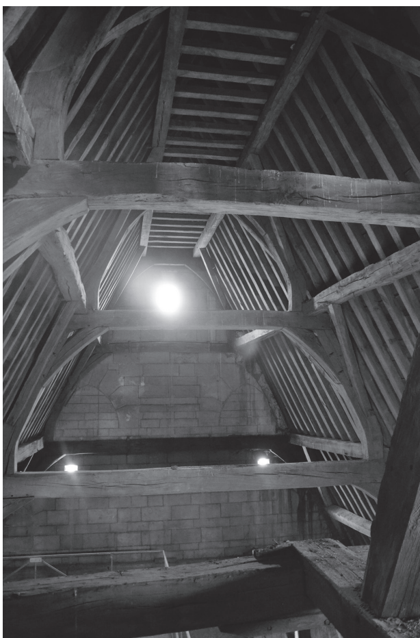
Fig. 12 – Bruxelles, église N.-D. du Sablon, charpente du bras sud du transept (1451-1453d) construite selon le modèle des toitures brabançonnaises à portiques. Photo : P. Hoffsummer ULG-CEA.
