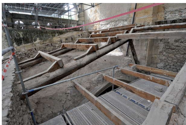
Fig. 12 – Charpente des première et deuxième travées du bas-côté sud (cl. S. Claude, DAMVA).
