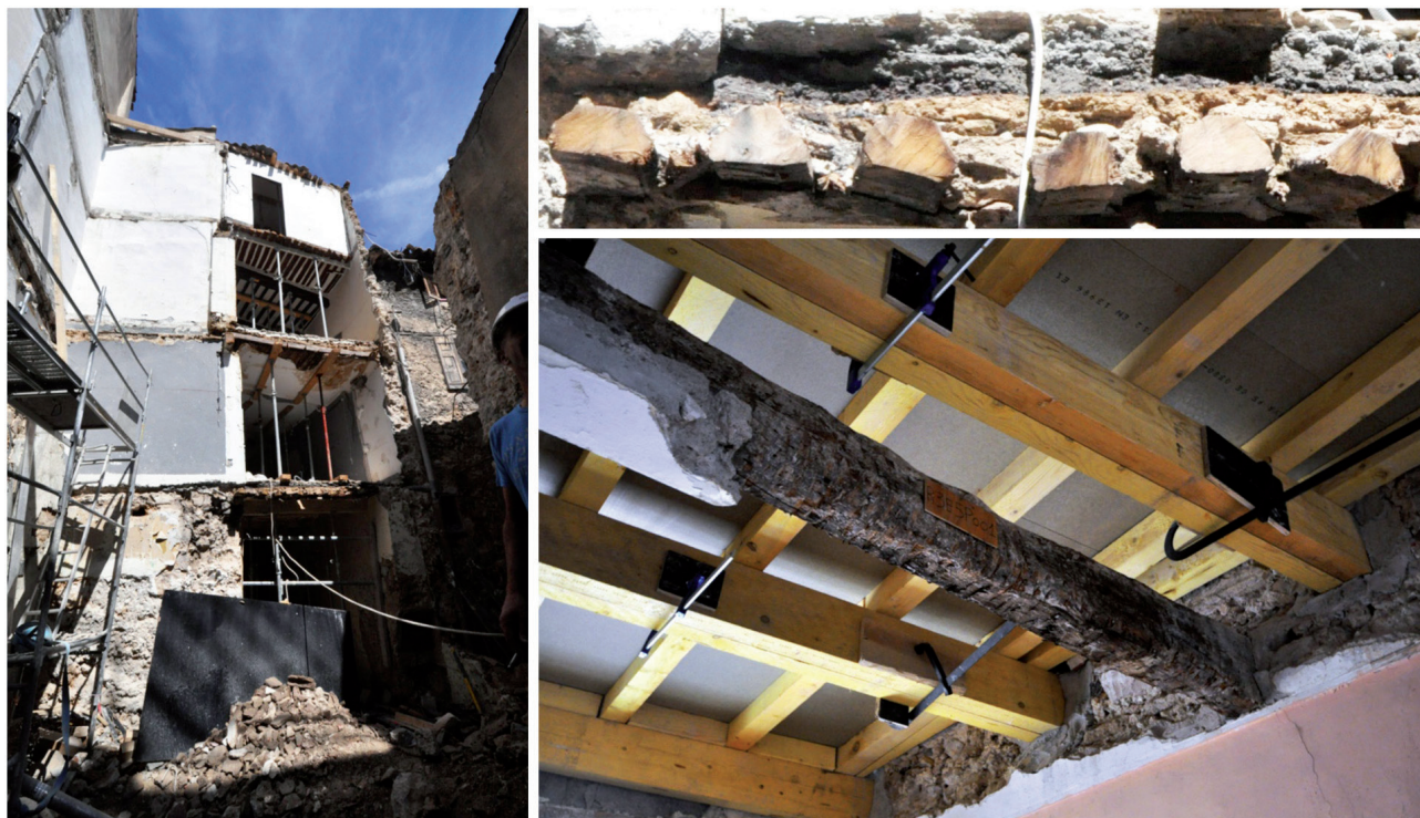
Fig. 3 – Îlot des Moulinets. Travaux de réhabilitation et suivi de dépose des poutres et planchers (clichés : F. Blanc).
