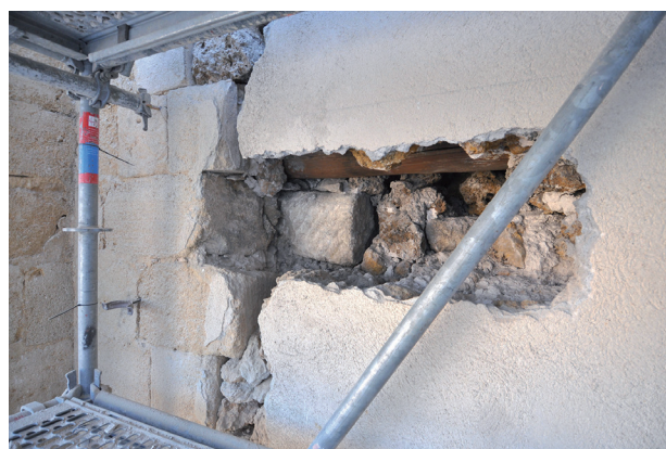
Fig. 17 – Poutre de chaînage insérée dans la maçonnerie du mur ouest du bras nord du transept (cl. S. Claude, DAMVA).
