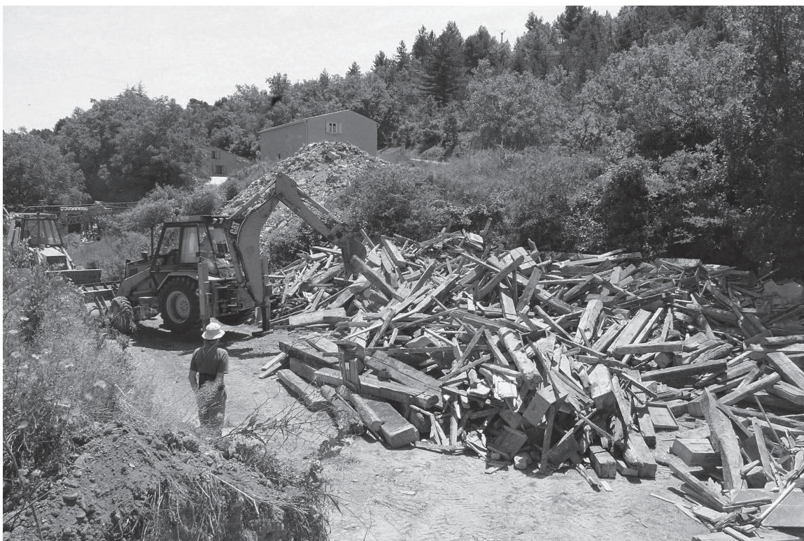
Fig. 2 – Pendant la déconstruction, certains éléments en bois ont été entreposés sur une aire de stockage, un terrain municipal à l'extérieur du centre-ville (cliché: L. Shindo).
