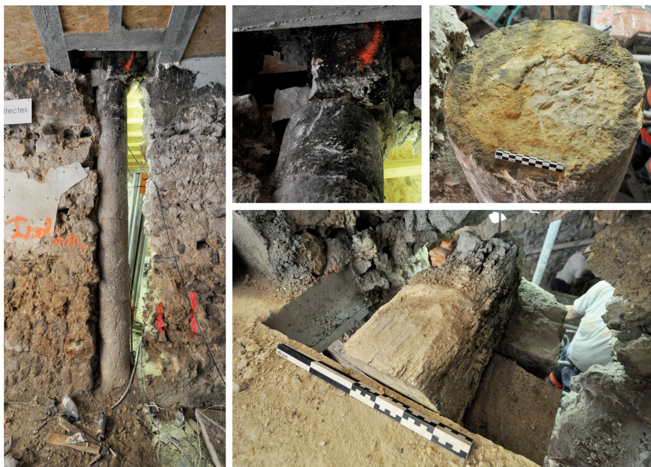
Fig. 2 – Îlot Sainte-Marthe: suivi de démontage d'un plancher dont une poutre sciée sur colonne était encore en place (clichés: F. Blanc).
