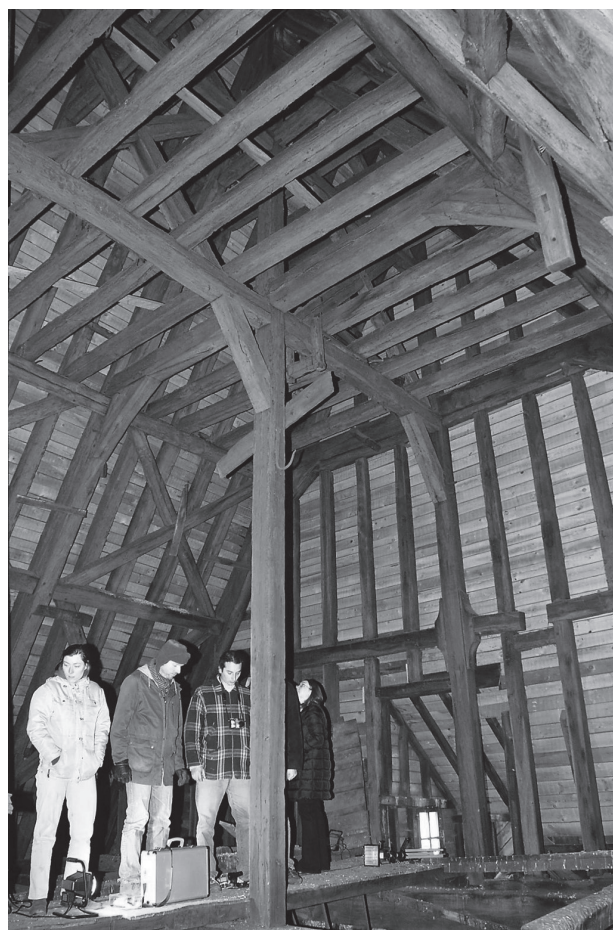
Fig. 13 – Liège (B.), église Saint-Denis, toiture du chœur avec sa fermeture provisoise (1422-1423d). Photo : P. Hoffsummer ULG-CEA.
