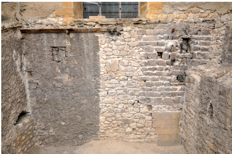
Fig. 6 – Vestiges du mur gouttereau médiéval, présents dans les combles de la cinquième travée du bas-côté sud (cl. S. Claude, DAMVA).
