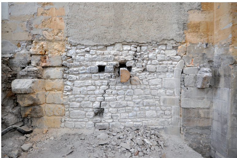
Fig. 7 – Vestiges du mur gouttereau médiéval et d'une ancienne fenêtre haute, présents dans les combles de la première travée du bas-côté sud (cl. S. Claude, DAMVA).
