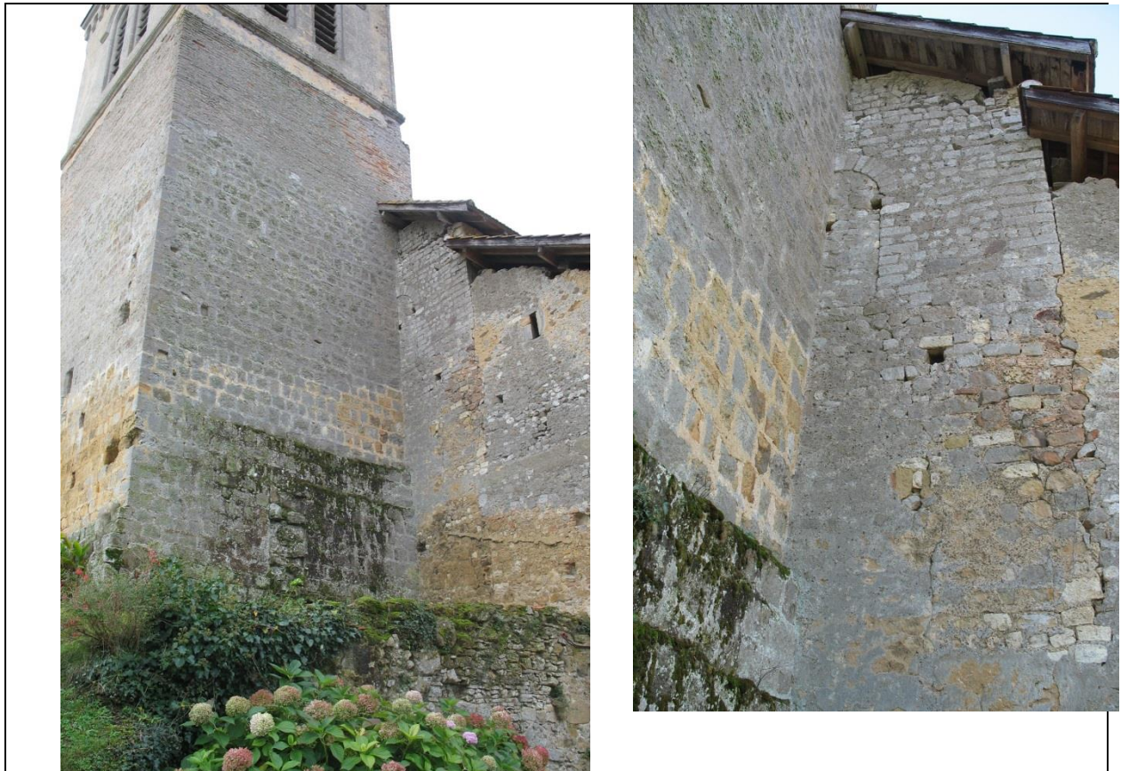
Fig. 18. Vue du chevet de l'église et de la base du clocher de l'église, comparaison des maçonneries (Clichés A. Champagne)
