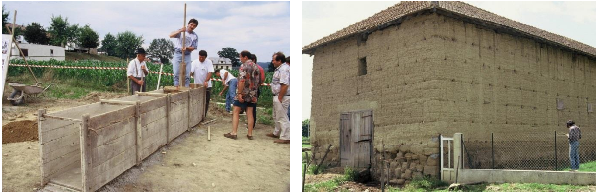
Fig. 25 : Réalisation d'une portion de mur, à l'aide d'un ancien coffrage à pisé, en 1995. Origine du coffrage : Guizérix (65). Coffrage en chêne, traverses métalliques. Dimensions du coffrage : 4,47 x 0,80 m (hauteur). A droite, ferme de Cho à Mont-d'Astarac (32). Les lignes horizontales des banchées et les trous de traverses sont parfaitement discernables. Banchées de 3,83 x 0,70 x 0,53 m (épaisseur).
