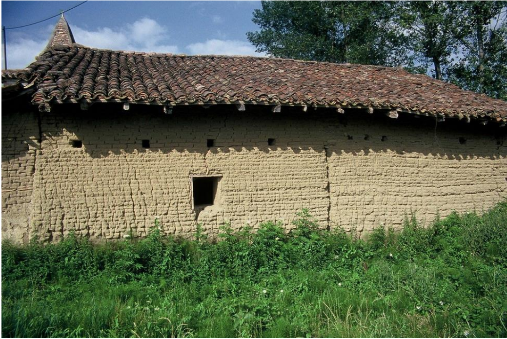
Fig. 23 : Ferme de Lafargue à Lafrançaise (82). Pisé procédant par couches continues compactées dans un coffrage étayé par l'extérieur. Absence de traces de traverses et d'arrêts de banchées
