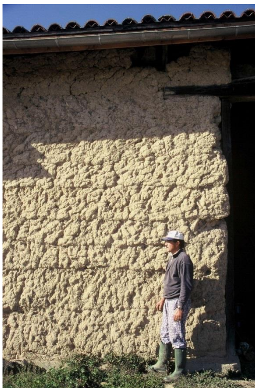
Fig. 26 : annexe de la ferme de Pierre-Lance à Poucharramet (31). Bauge procédant par hautes levées de hauteurs irrégulières, composées de pains disposés de manière aléatoire. Parements redressés et compactés à la trique. Construction après 1830.
