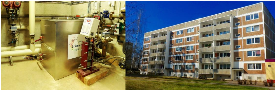
Figure 27. Chaudière numérique Stimergy installé dans un bâtiment à Échirolles AVEC L'OPAC 38, Stimergy. Crédit =© Stimergy, 2018.
