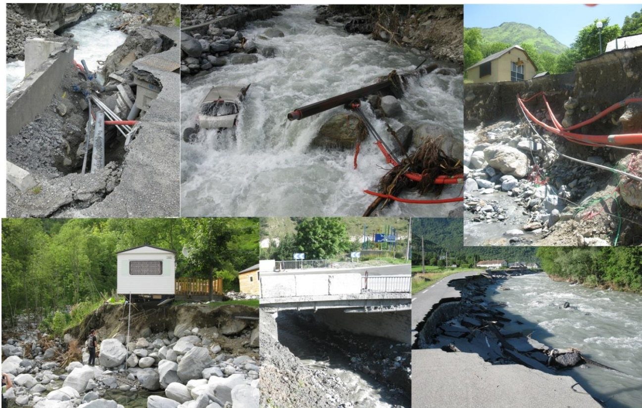
Figure 22 : Les crues torrentielles peuvent causer des dégâts sur des infrastructures critiques ( réseaux de transport, énergie...) (Tacnet et al. 2016)
