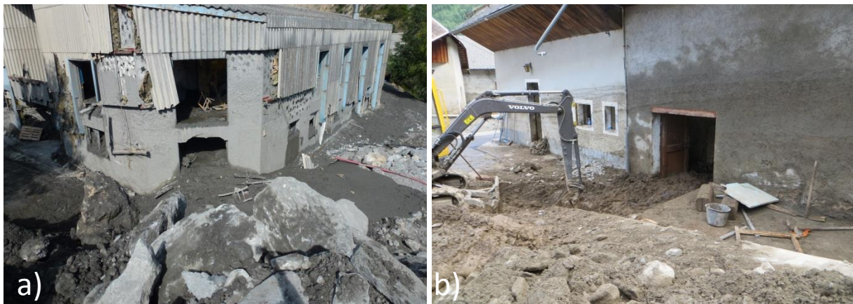
Figure 17 : Illustration de la résistance des murs structurants : (a) Modane (73), lave torrentielle du Saint Antoine de 2014, vue amont du dépôt de bus. Les tôles de couvertures ont été arrachées alors que la structure en béton semble relativement intacte, la lave torrentielle a pourtant laissé des marques jusqu'au deuxième étage (© Guillaume PITON) et (b) crue de charriage hyper-concentré du torrent du Grand Rocher, Chantelouve (38) 2014, le bâtiment engravé jusqu'au niveau du premier étage ne porte pourtant pas de trace de dommages mises à part les traces d'humidification (© Marie Spitoni)
