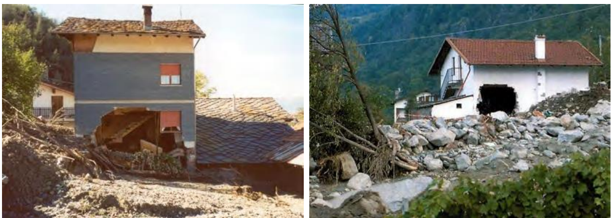
Figure 20 : Destruction de murs par impact de blocs : Val d'Aoste 2000 (© Région Autonome Vallée d'Aoste)
