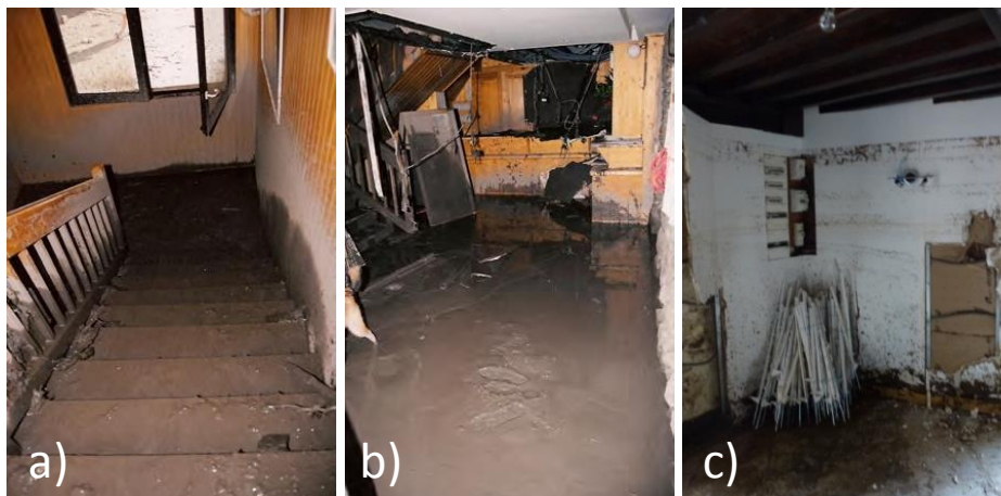
Figure 13 : (a et b) Envahissement de constructions : Saint-Chaffrey, crue du Peytavin, 1995. Les escaliers empruntés par la boue et les dégâts au niveau inférieur (© ONF-RTM 05) et (c) crue de charriage hyper-concentré du torrent du Grand Rocher, Chantelouve, 2014 : traces laissées après dégagement des graviers qui atteignaient presque les poutres du plafond du rez de chaussée de la maison de Chantelouve (même maison que celle vue d'extérieur sur la Figure 17b). (© Guillaume PITON)
