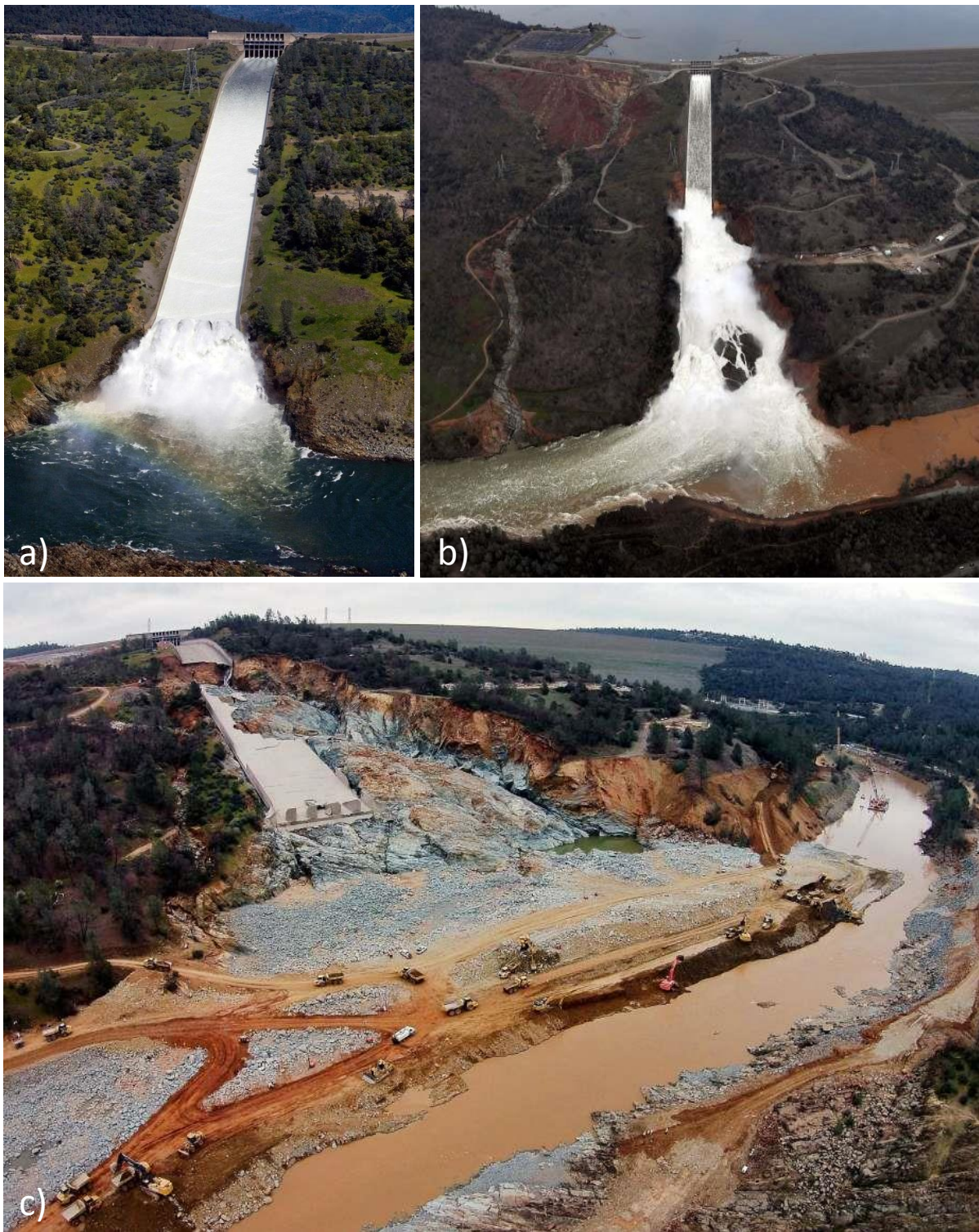
Figure 1 : Exemple d'expression du caractère torrentiel d'un écoulement normalement confiné suite au disfonctionnement d'un ouvrage - Barrage d'Oroville en Californie, crise de février 2017 : (a) évacuateur de crue en béton armé, fonctionnement normal avec écoulement rapide (supercritique), blanchi par l'entraînement de l'air mais sans transport solide ; (b) rupture partielle du radier de l'ouvrage générant un écoulement sur le versant, des érosions massives et un risque de vidange incontrôlée du réservoir si l'érosion se propage jusqu'au lac ; (c) état final après 20 jours d'écoulements, érosion massive du versant n'atteignant pas le lac, végétation, matériaux mobiles et roche mère attaqués, impressionnante expression de la torrencialité d'un système normalement sous contrôle (photos © Paul Hames / California Department of Water Resources, Josh Edelson/AFP/Getty Images et San Francisco Chronicle )
