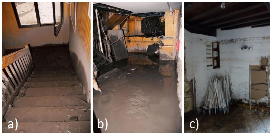
Figure 13 : (a et b) Envahissement de constructions : Saint-Chaffrey, crue du Peytavin, 1995. Les escaliers empruntés par la boue et les dégâts au niveau inférieur (© ONF-RTM 05) et (c) crue de charriage hyper-concentré du torrent du Grand Rocher, Chantelouve, 2014 : traces laissées après dégagement des graviers qui atteignaient presque les poutres du plafond du rez de chaussée de la maison de Chantelouve (même maison que celle vue d'extérieur sur la Figure 17b). (© Guillaume PITON)
