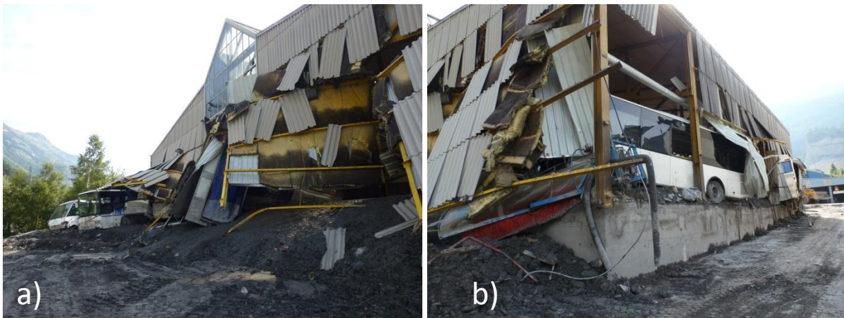
Figure 19 : Modane, lave torrentielle du Saint Antoine de 2014, vue de l'aval du dépôt de bus. Les bus, soulevés par la lave torrentielle (épaisseur 1.5 – 2 m) ont été déplacés et sont passés à travers la paroi en tôle du dépôt. La structure métallique porteuse a toutefois tenu ((a) © Guillaume PITON et (b) Simon CARLADOUS, ONF-RTM DN)
