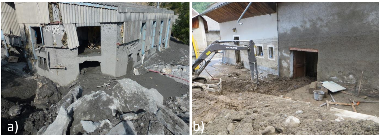
Figure 17 : Illustration de la résistance des murs structurants : (a) Modane (73), lave torrentielle du Saint Antoine de 2014, vue amont du dépôt de bus. Les tôles de couvertures ont été arrachées alors que la structure en béton semble relativement intacte, la lave torrentielle a pourtant laissé des marques jusqu'au deuxième étage (© Guillaume PITON) et (b) crue de charriage hyper-concentré du torrent du Grand Rocher, Chantelouve (38) 2014, le bâtiment engravé jusqu'au niveau du premier étage ne porte pourtant pas de trace de dommages mises à part les traces d'humidification (© Marie Spitoni)
