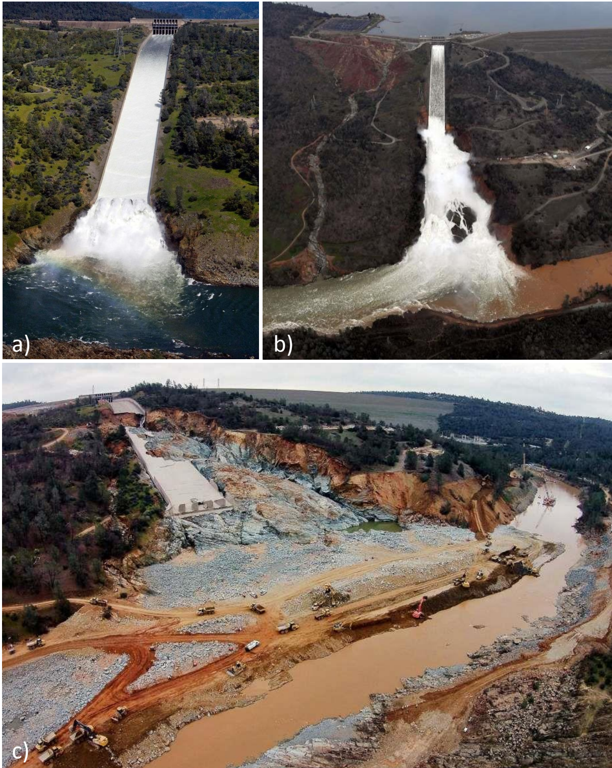
Figure 1 : Exemple d'expression du caractère torrentiel d'un écoulement normalement confiné suite au disfonctionnement d'un ouvrage - Barrage d'Orroville en Californie, crise de février 2017 : (a) évacuateur de crue en béton armé, fonctionnement normal avec écoulement rapide (supercritique), blanchi par l'entraînement de l'air mais sans transport solide ; (b) rupture partielle du radier de l'ouvrage générant un écoulement sur le versant, des érosions massives et un risque de vidange incontrôlée du réservoir si l'érosion se propage jusqu'au lac ; (c) état final après 20 jours d'écoulements, érosion massive du versant n'atteignant pas le lac, végétation, matériaux mobiles et roche mère attaqués, impressionnante expression de la torrencialité d'un système normalement sous contrôle (photos © Paul Hames / California Department of Water Resources, Josh Edelson/AFP/Getty Images et San Francisco Chronicle )
