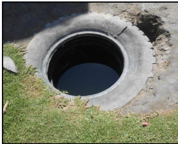
Figure 5 : Puits artisanal non protégé dans le quartier de Mahavatse II. (Source : Mara, 2016)
