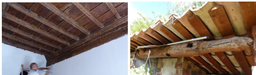
Plafond à poutre et solives apparentes, et arbre de moulin en réemploi (Prads)
