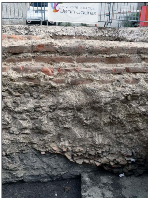
Figure 70 : Cliché de la face méridionale du MUR303 sur lequel on distingue l'élévation 3011 et le ressaut de la fondation 3105. En bas, il est possible de voir les vestiges du niveau de gravats (3096) piégé dans le mortier du mur.
