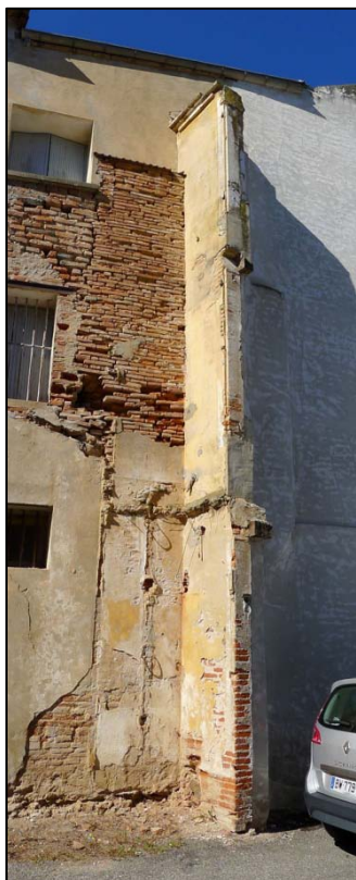
Figure 62 : L'arrachement du MUR002 photographié en 2014. On distingue les piédroits des baies des trois niveaux d'élévation.
