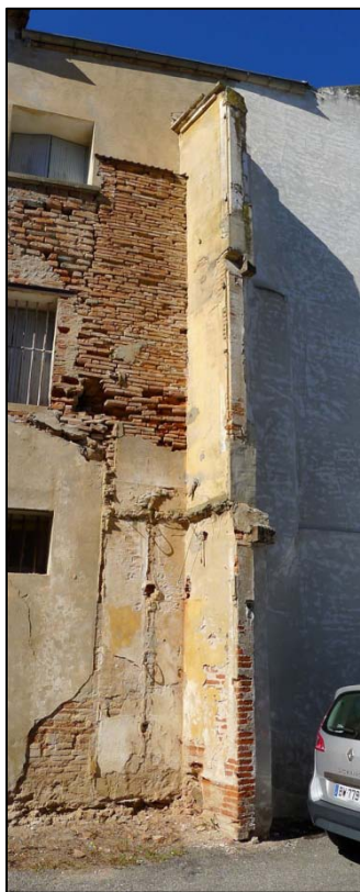
Figure 62 : L'arrachement du MUR002 photographié en 2014. On distingue les piédroits des baies des trois niveaux d'élévation.
