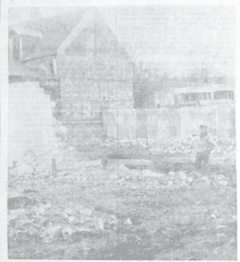
Une des équerres du bâtiment 1, près d'un mur qui, quelques instants plus tard, ne sera que poussière.
