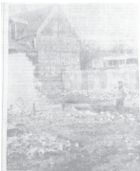
Une des équerres du bâtiment 1, près d'un mur qui, quelques instants plus tard, ne sera que poussière.
