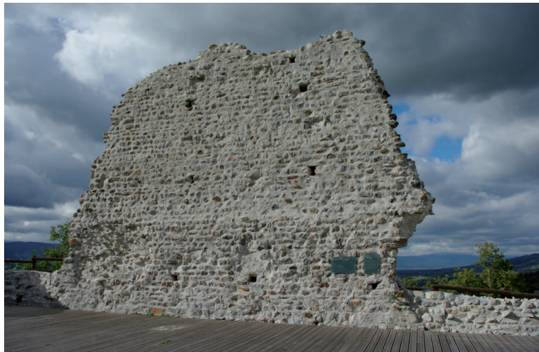
(FIG. 20) Faucigny. Vestiges du corps de logis du château médiéval et panneaux associés. © J. Laidebeur - SDAHS, 2009.
