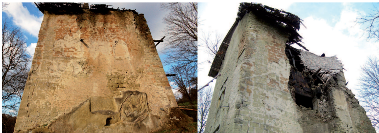
(FIG. 30) Mûres. Tour de Pierrecharve en 2009, puis en 2010, après son effondrement partiel. © L. D'Agostino - SDAHS.
