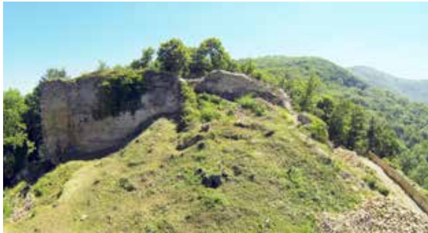
fig. 4 Bâtiments résidentiels du château de Saint-Germain en 2013 ; de gauche à droite, la tour de la chapelle fouillée dans les années 1970, le logis et la tour maîtresse. On estime à 200 m 3 le volume de gravats recouvrant la tour
