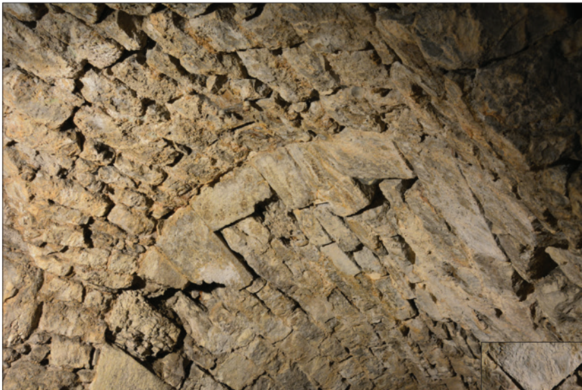
Fig. 27 : Césure entre la voûte du palier et celle de la volée inférieure de l'escalier. Cliché : E. Chauvin-Desfleurs.
