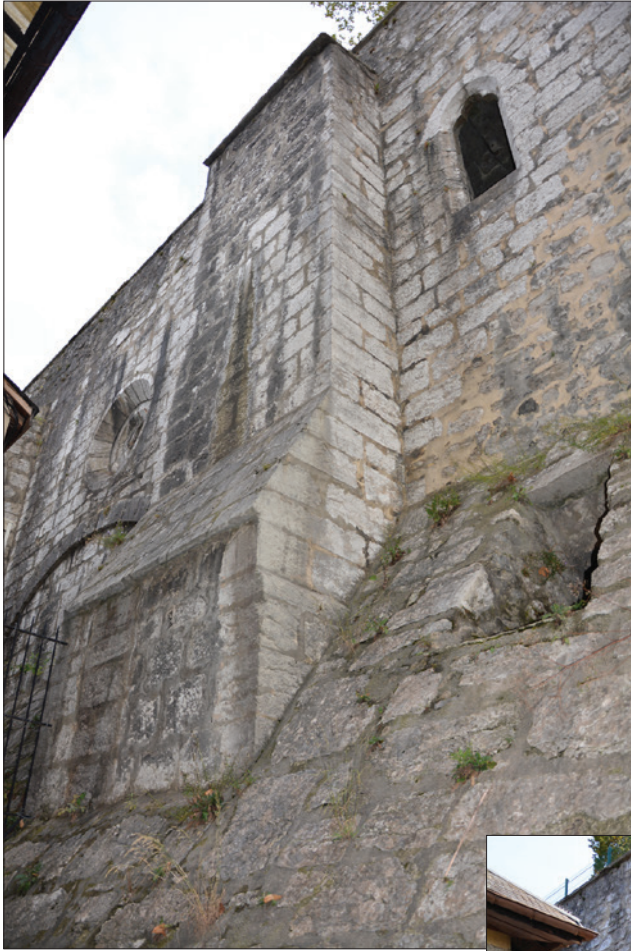
Fig. 79 : Les structures bâties dans les années 1310 sur le parement nord (contreforts, grande arcade et baies). Cliché : E. Chauvin-Desfleurs.
