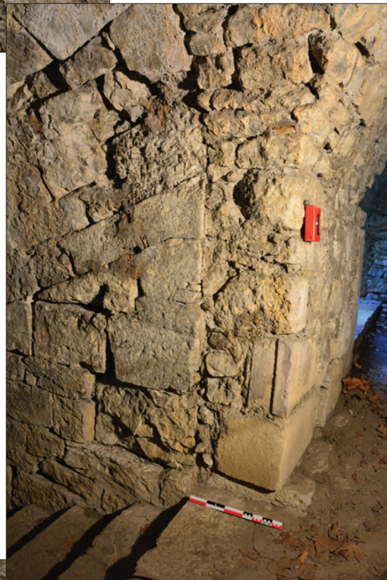
Fig. 28 : Césure entre le piédroit nord de la volée inférieure de l'escalier et le mur ouest du palier intermédiaire. Cliché : E. Chauvin-Desfleurs.
