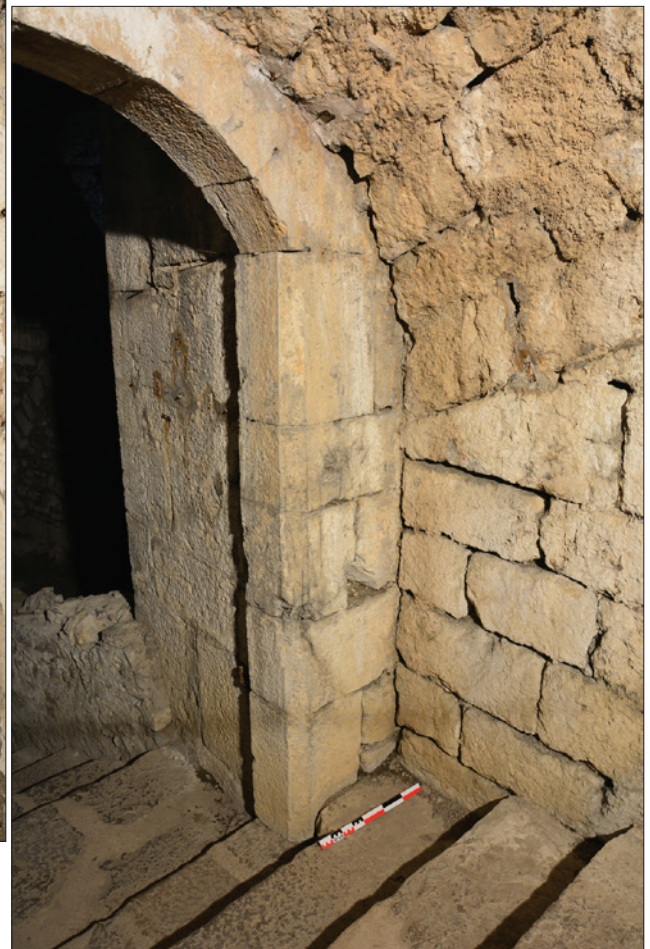
Fig. 32 : Absence de chaînage entre la porte d'accès aux Salles basses et le mur d'échiffre nord de l'escalier. Cliché : E. Chauvin-Desfleurs.
