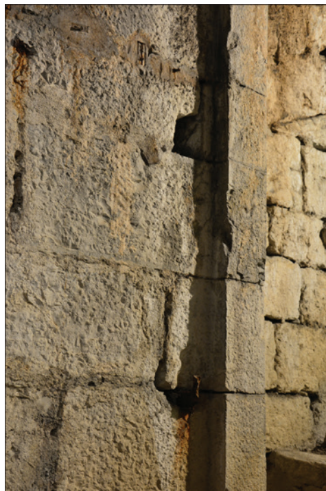
Fig. 36 : Détail du gond inférieur et du trou barrier sur le tableau nord de la porte d'accès aux Salles basses, témoins des anciens vantaux. Cliché : E. Chauvin-Desfleurs.
