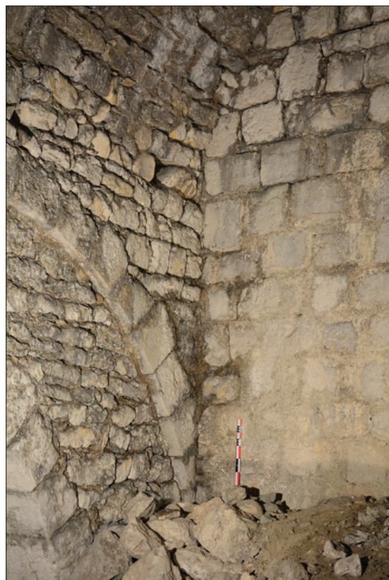
Fig. 47 : Retombée de la grande arcade nord contre le mur oriental de la salle. Cliché : E. Chauvin-Desfleurs.
