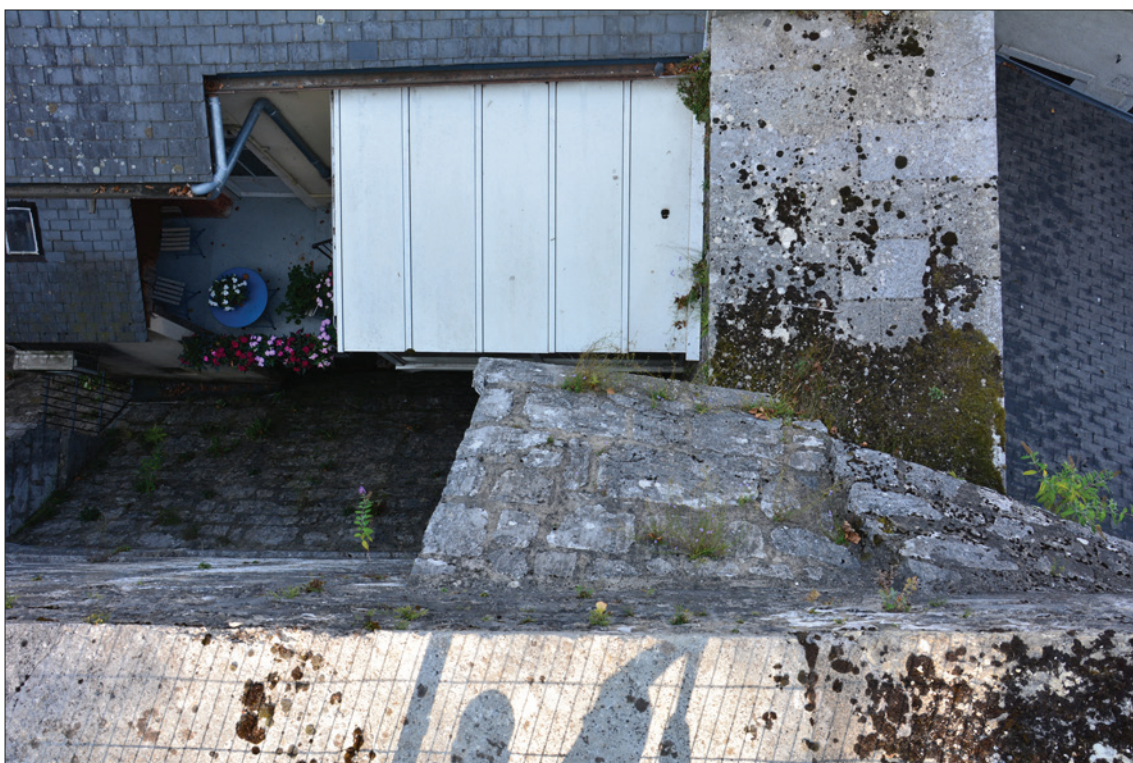
Fig. 83 : Chemisage du contrefort oriental par la courtine ouest de la ville au droit de la courtine nord du château. Cliché : E. Chauvin-Desfleurs.
