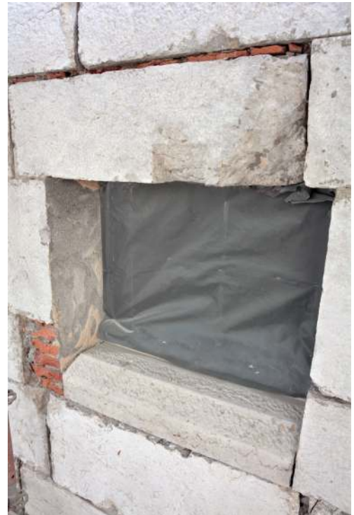
Fenêtre UC 33.01 éclairant les latrines du troisième niveau ; elle a remplacé un petit jour dont seul le linteau à chanfrein est encore conservé
