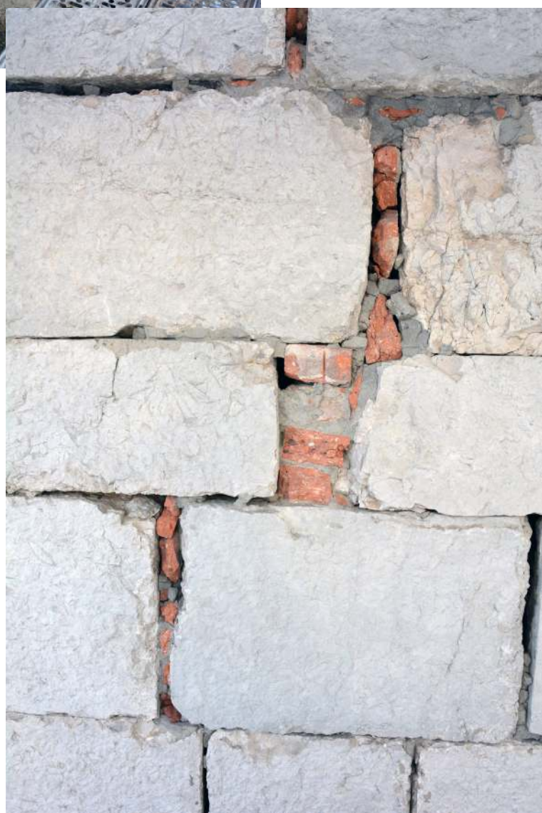
Fissure bouchée par des fragments de terre cuite sur le mur ouest (M34)
