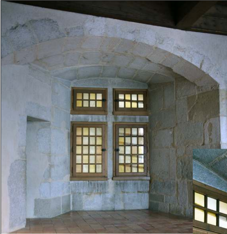
Fenêtre UC 31.01 et chemisage au niveau du tableau oriental.
