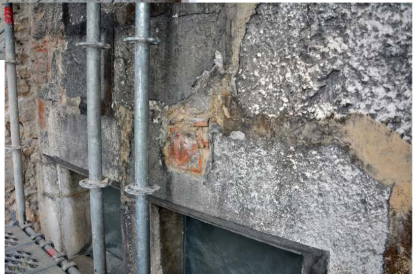
Série de trous bouchés au niveau des linteaux des baies du premier étage.
