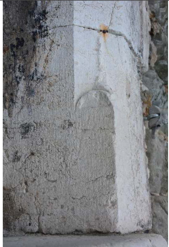
Piédroit sud, congé dégradé
