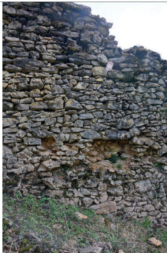
2. Lacunes dans le parement ouest.
