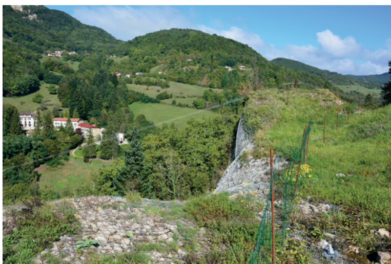
3. Barrières de protection de la cour haute à l'ouest et confortement de la courtine ouest (filet pare-gravois et béton projeté).
