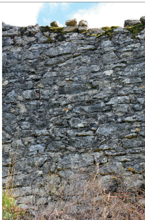
2. Restauration ancienne de la courtine sud-ouest.
