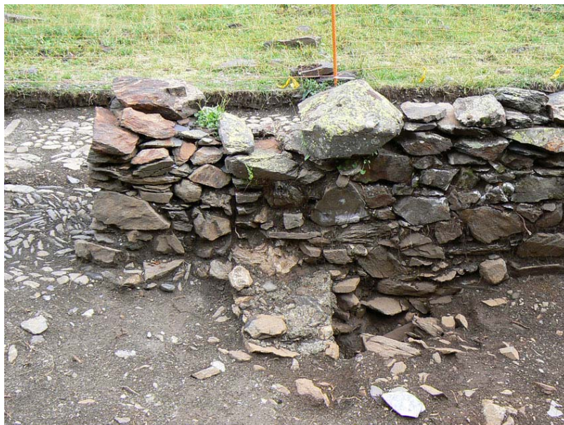
Vista desde el norte del muro UE 60, y su zanja constructiva UE 61, adosado al muro UE 39.
