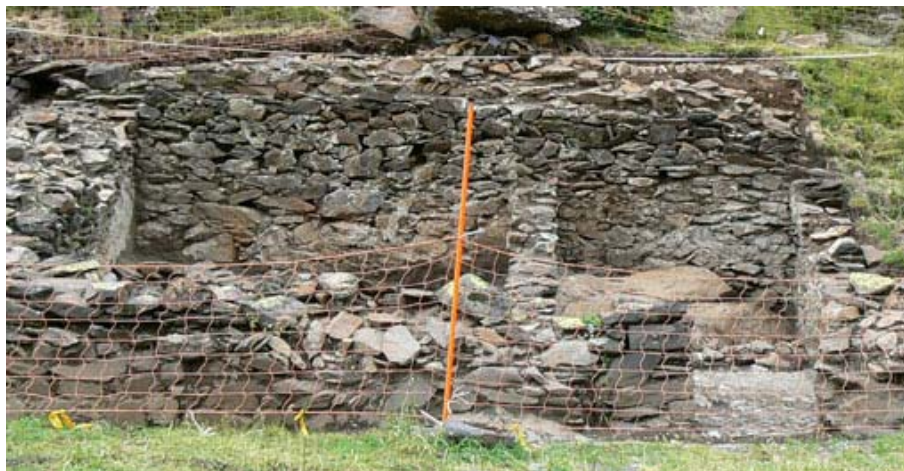
Vista Frontal de UE 15 desde el sur, Este muro recorre todo el interior norte del edificio.
