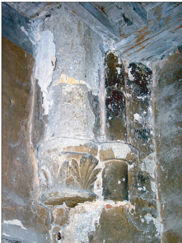
Chapiteau et colonnette de l'arc triomphal gothique, côté nord. Les retombées verticales des colonnettes ont été bûchées lors de la construction des cloisons du XIXème siècle.
