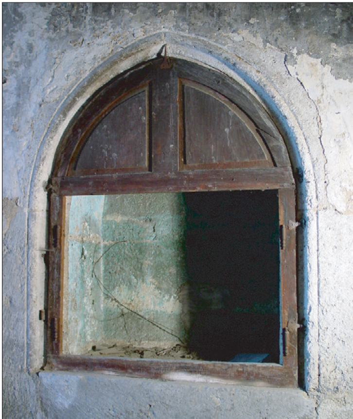
Lavabo liturgique du choeur gothique, état avant intervention.
