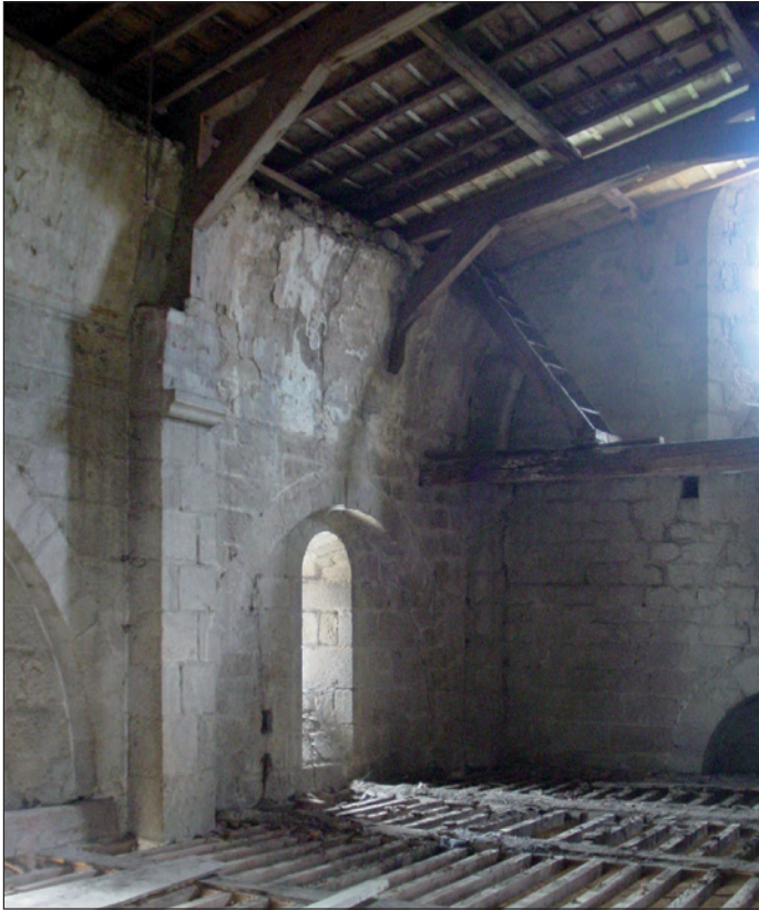
Intérieur de la nef, vue de la voûte effondrée et des pilastres.
