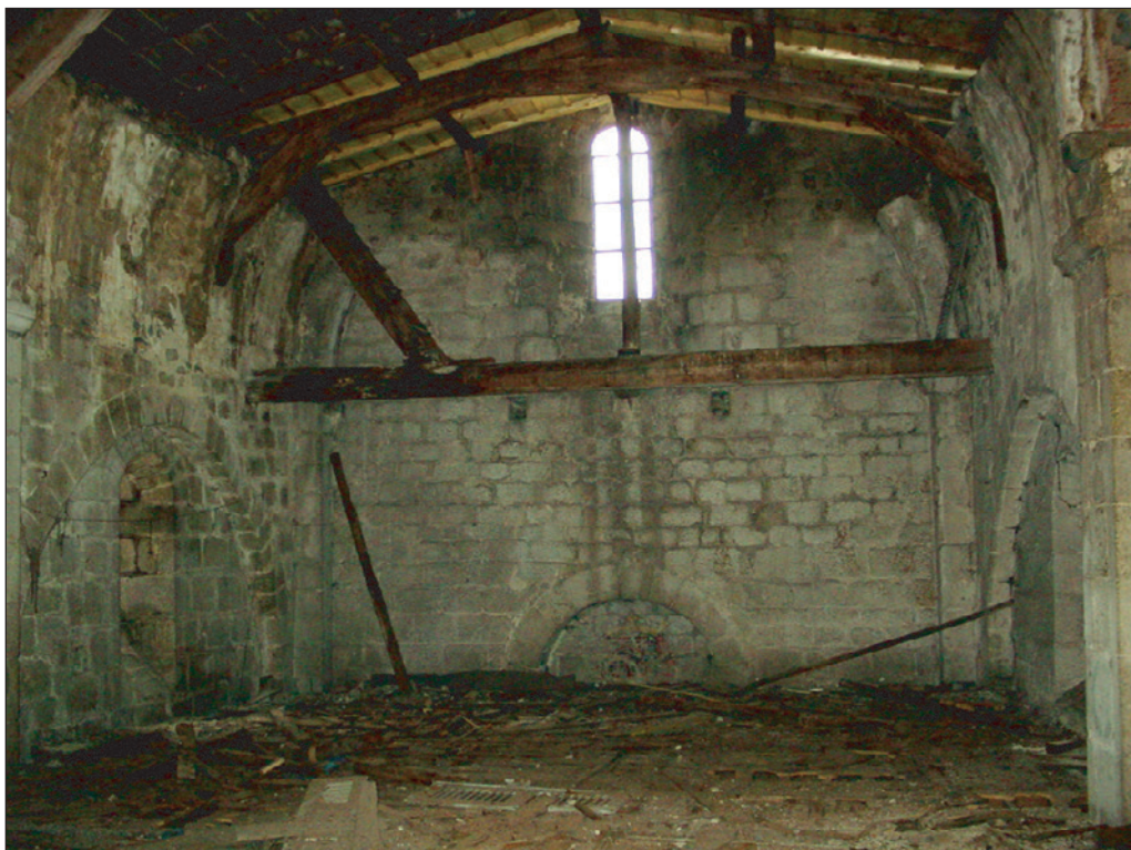
Etat du plancher de la nef en 2003.
