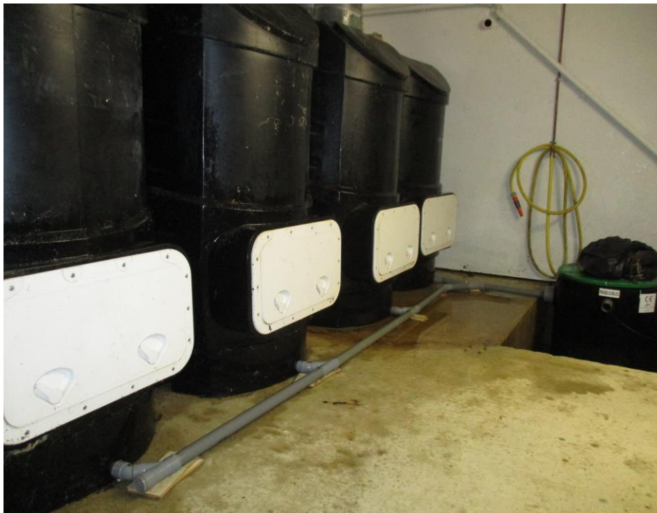
Figure 17 : Réseau de transfert avec des coudes à 22° et 45° Ø 50 mm
